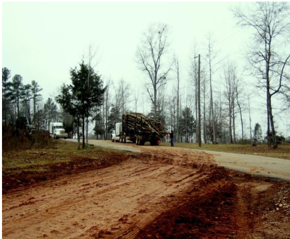
Erosión del mala preparación del sitio.
